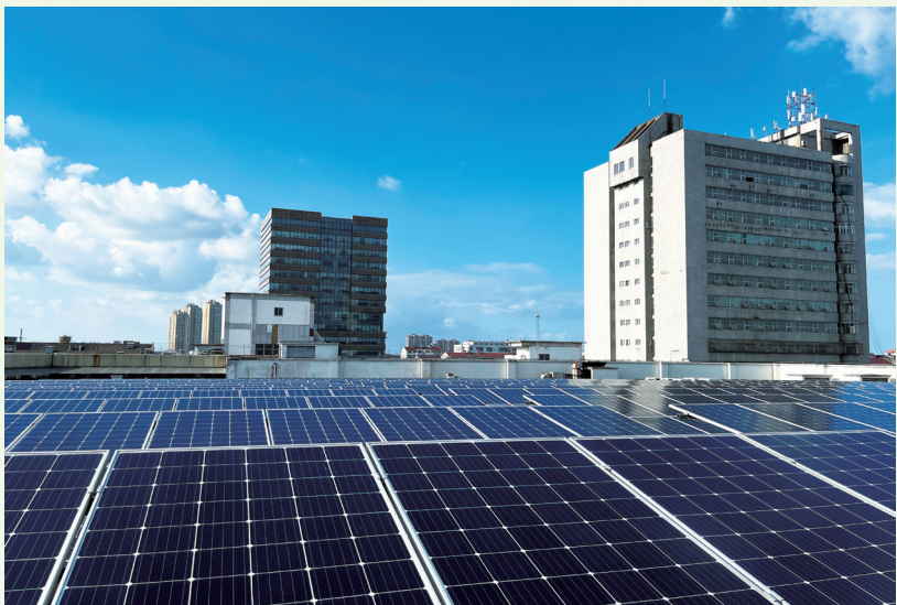
苏州绿谱新能源发展有限公司工商业分布式光伏发电项目
